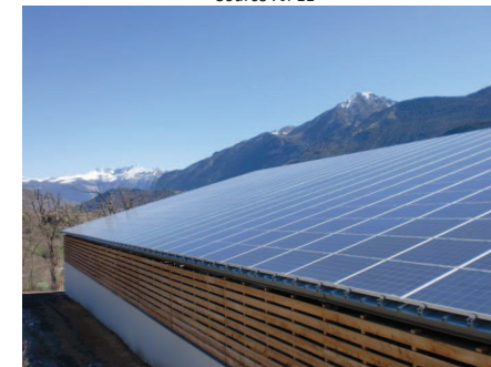
Photo 3 : Centrale photovoltaïque d'Embrun exploitée par JPEE
